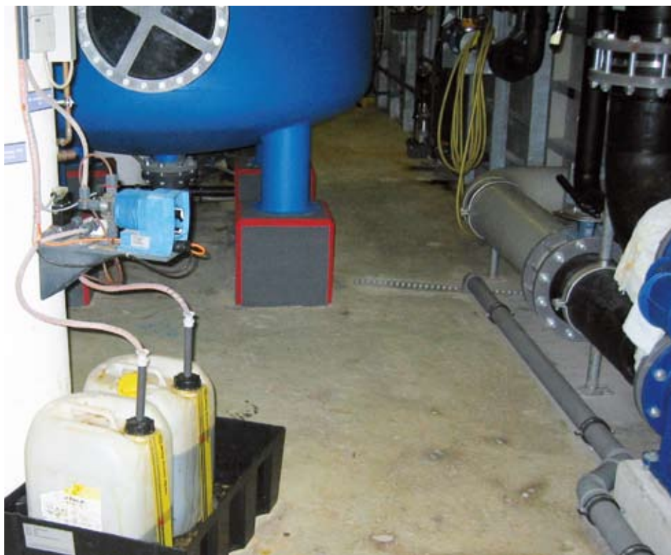
Bild 12: Behälter mit Flockungsmittel bei der Entnahme
