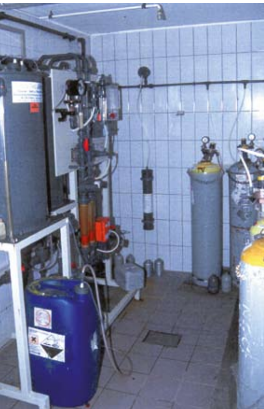
Bild 5: Natriumchloritlösung im Chlor-/Chlordioxidverfahren
