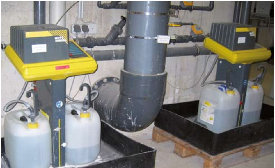
Bild 11: Behälter mit Lauge bei der Entnahme
