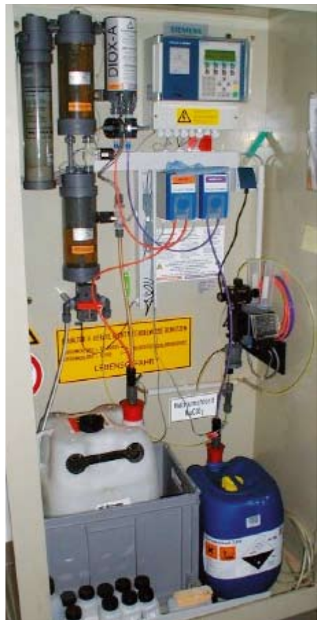
Bild 6: Chlordioxid nach dem Salzsäure-Natriumchloritverfahren
